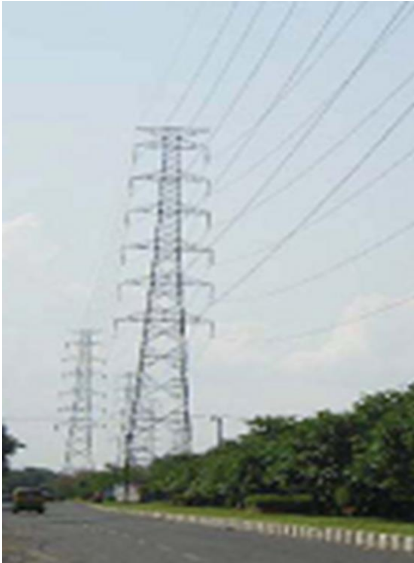
SUTT 70 KV & 150 KV
